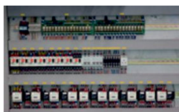
Электрический шкаф управления
